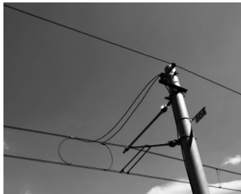
图 1-11 轨道交通架空柔性接触网
