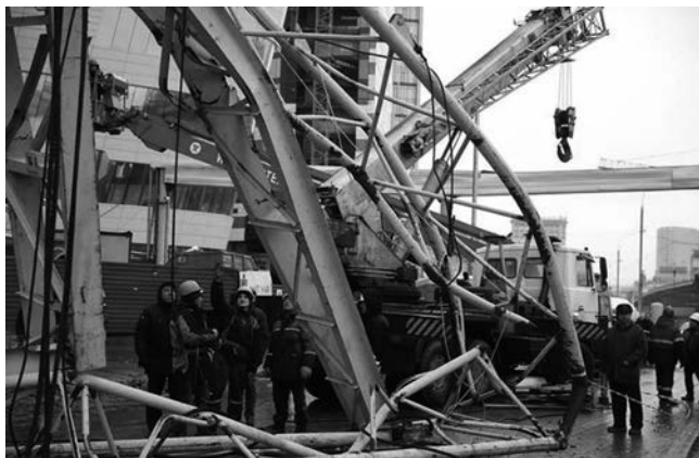
图 1-1 四川简阳塔式起重机坍塌事故现场
